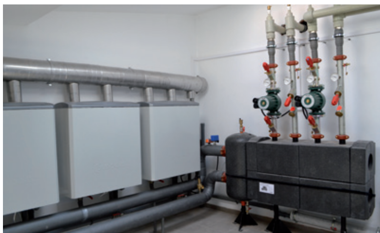
Рис.2 Крышная котельная ресторана, 360 кВт
