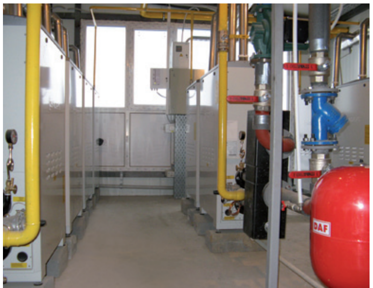
Рис. 6 Крышная котельная гостиничного комплекса
